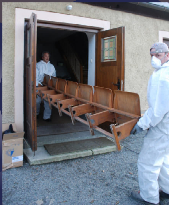
8. Februar 2020 das Holz an der Stelle muss entsorgt werden
