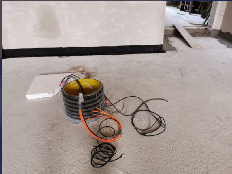
13. August 2021: Kabel im Medienschacht
