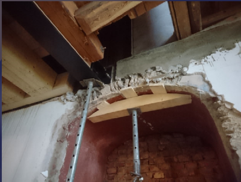
5. Mai 2021: Betonsturz unter der Orgelempore
